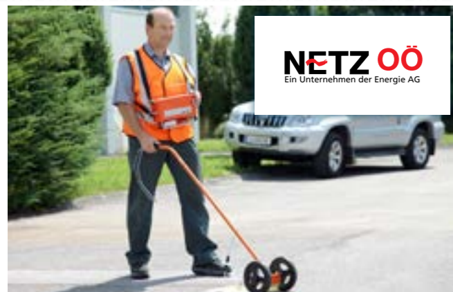
Im Zuge der routinemäßigen Wartung des Gasnetzes wird die Leitungstrasse mit einem Gasspürgerät abgegangen und auf Funktionstüchtigkeit geprüft.
